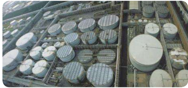
廢水處理場 (改善後)
